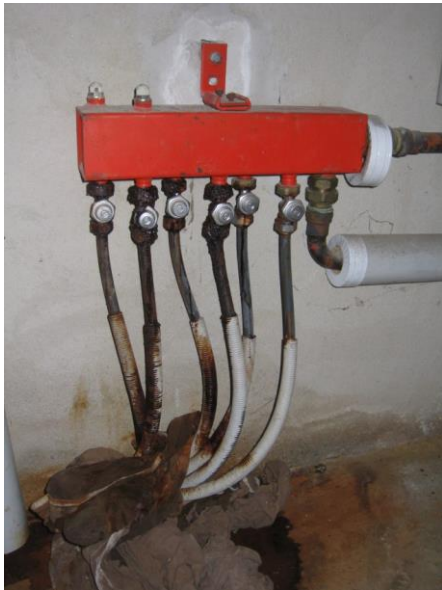
Abb. 57: Heizungsverteiler aus Messing (rot angestrichen), Rohre aus Stahl, direkter Kontakt → Kurzschlusselement
